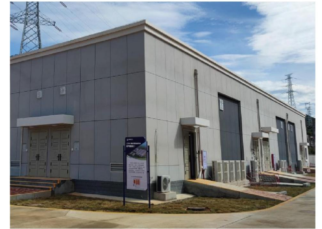
国网时代宁德霞浦储能电站数字孪生项目 （200MW/400MWh）
