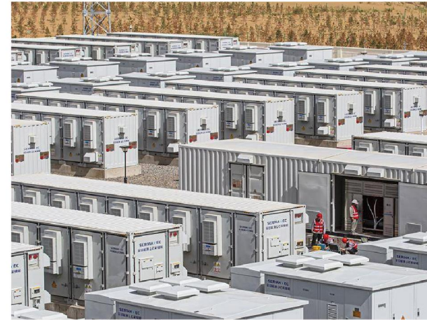
蒙西基地库布其200万千瓦光伏治沙项目 1#储能电站（80MW/160MWh）
